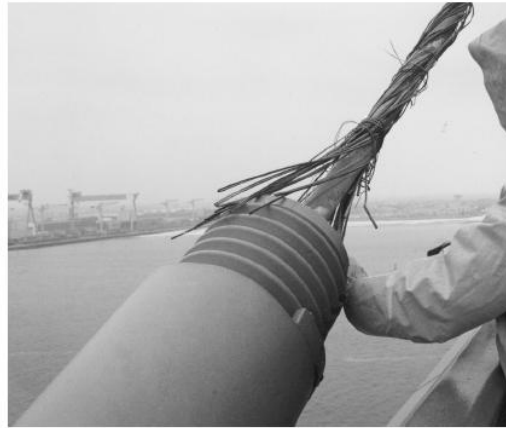
圖 1 斜拉索疲勞斷裂破壞情形(Siebert and Brevet 2006)
